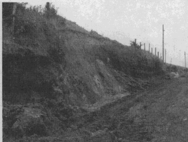
Fotografía 4: Desprendimientos de suelo y roca, nótese el carácter superficial y puntual de dicho proceso.
