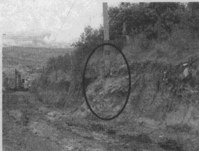
Fotografía 2: Panorámica del extremo occidental de la vía en construcción; obsérvese la pérdida del suelo de fundación de un poste de energía a raíz de las excavaciones realizadas.
