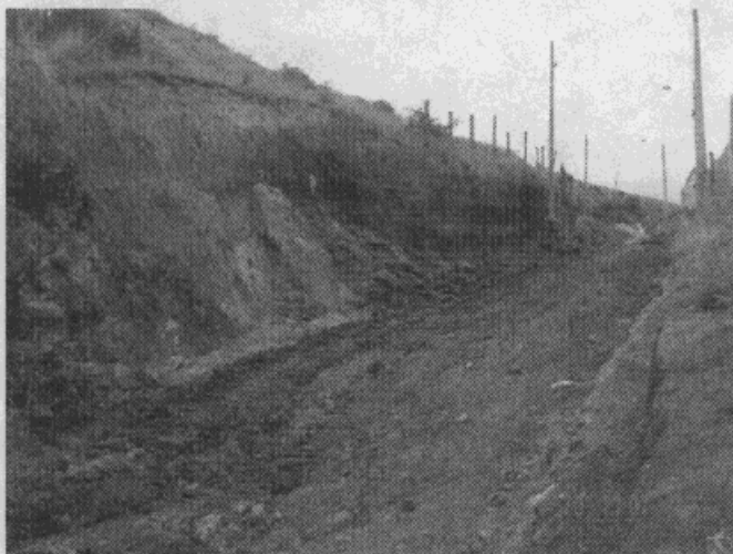
Fotografía 1: Panorámica del extremo oriental de la vía en construcción; obsérvese los taludes conformados a raíz de las excavaciones realizadas.
