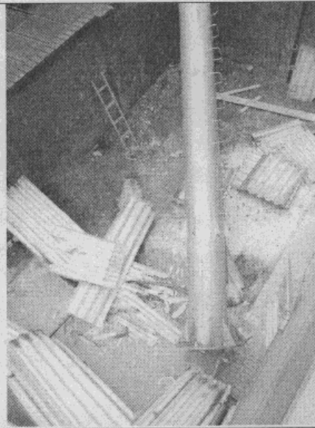
Fotografía 2: Mástil caído sobre cubiertas en teja plástica.
