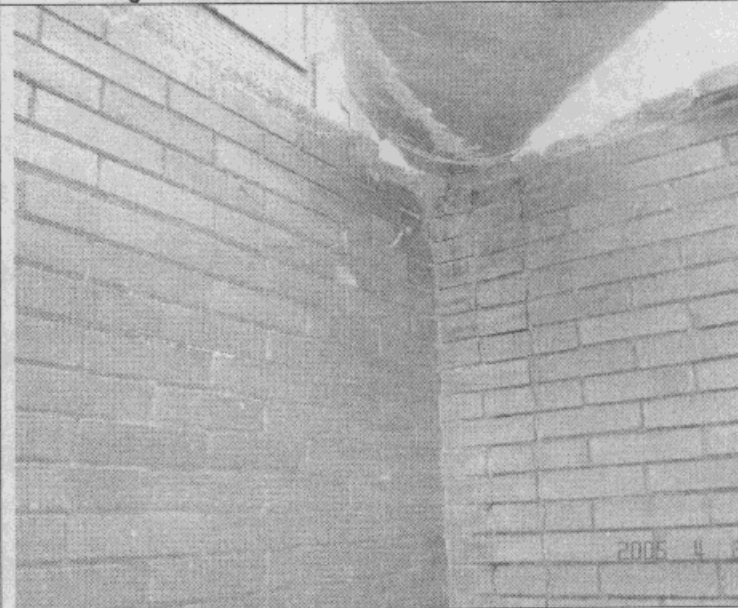
Fotografía 4: Afectaciones en los muros medianeros.
