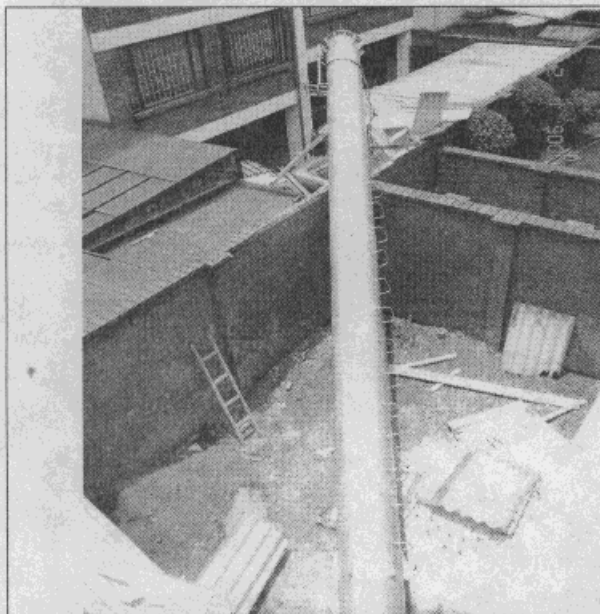
Fotografía 1: Mástil caído sobre el muro de cerramiento
