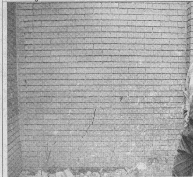
Fotografía 3: Grietas en el muro medianero
