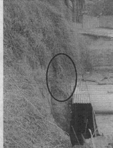
Foto 2. Aspecto del talud de corte, la zona donde se presentaron los desprendimientos de material (óvalo) y la cubierta de la vivienda del Señor Márquez.
