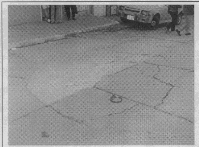
Fotografía 2: Hundimiento y fracturas en las losas del pavimento en concreto.
