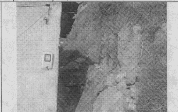
Fotografía 3. Talud de corte en el costado oriental del predio, bloques muy susceptibles al desprendimiento o colapso.
