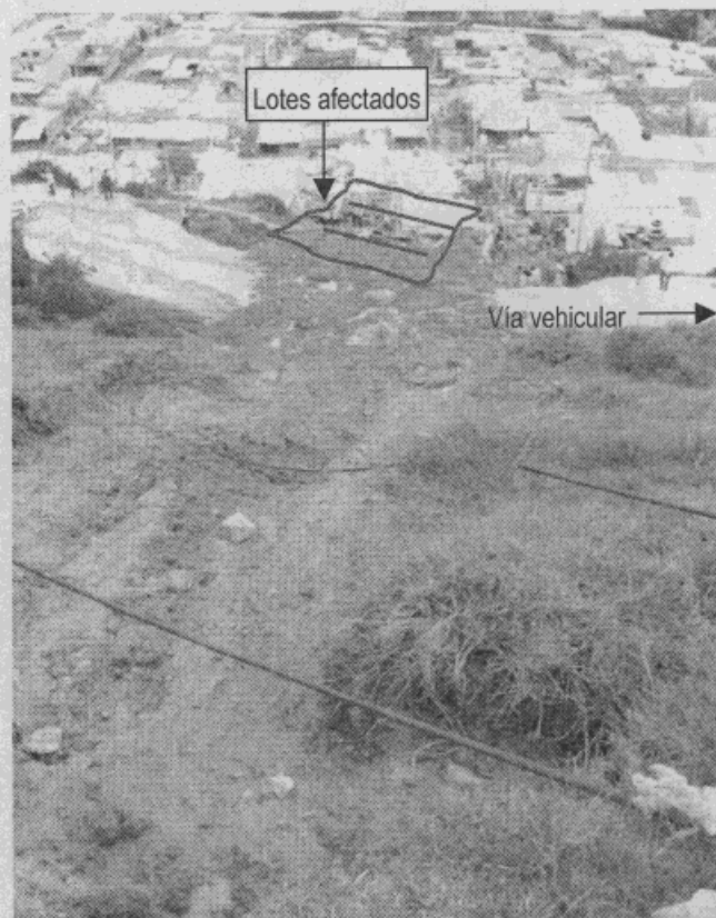
Foto 2. Fotografía desde la corona del flujo de tierras, se observa hacia abajo la afectación sobre la vía vehicular y los predios de la manzana 8 del barrio Caracolí.
