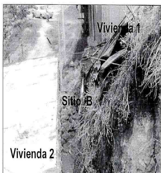
Fotografía 4 Vista del deslizamiento Zona B hacia el sur
