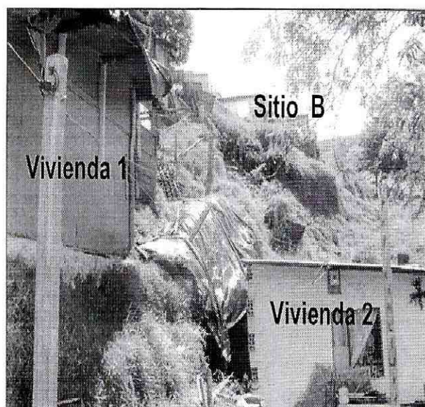
Fotografía 3 Vista del deslizamiento Zona B hacia el norte
