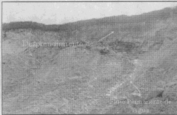
Fotografía 4 Escarpe y flujo permanente de agua
