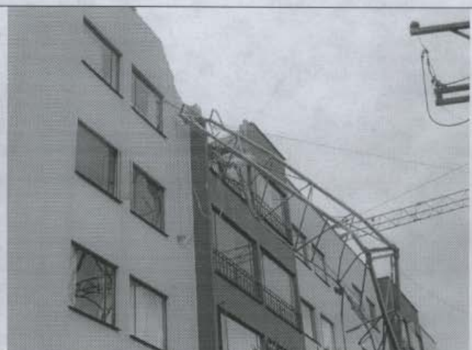
Fotografía 2: Afectaciones en fachada y cubierta del edificio Especialmente los apartamentos 502 y 501.
