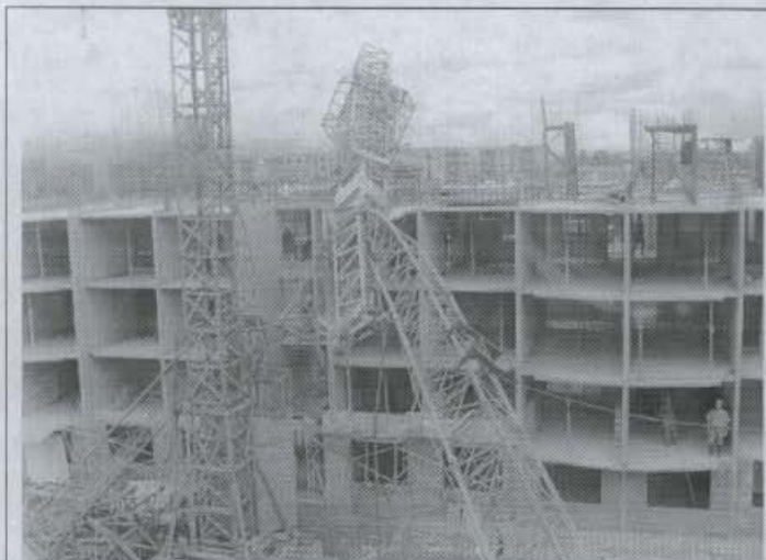
Fotografía 1: Vista de la Pluma grúa que colapsó en el extremo de la obra en construcción.
