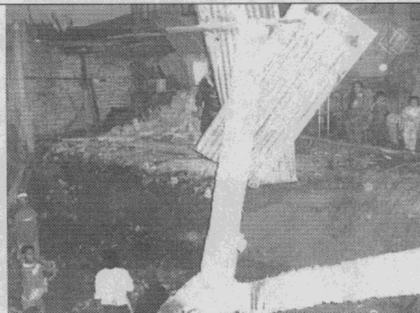
Fotografía 5. Afectación del talud de cimentación y colapso de la estructura y muro de cerramiento del taller en la Q. Trompeticas.
