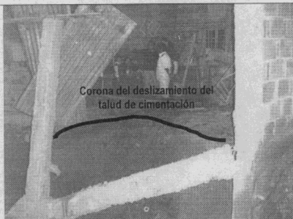
Fotografía 4. Afectación del talud de cimentación y colapso de la estructura y muro de cerramiento del taller en la Q. Trompeticas.
