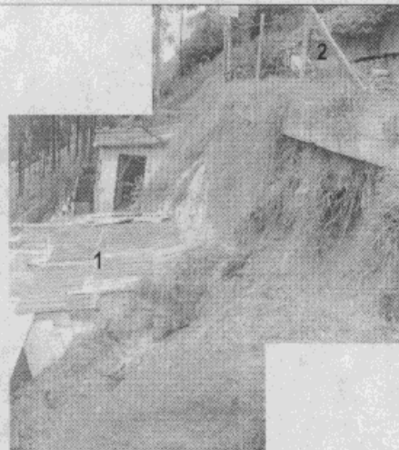
Foto 2. Deslizamiento en el talud de corte que limita el predio de la Señora Rivera (1) y el predio del FOPAE (2).
