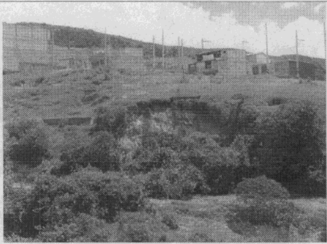
Foto 2. Deslizamiento que afecta el talud vial de la carretera que comunica los Barrios Puerta al Llano y el Refugio.
