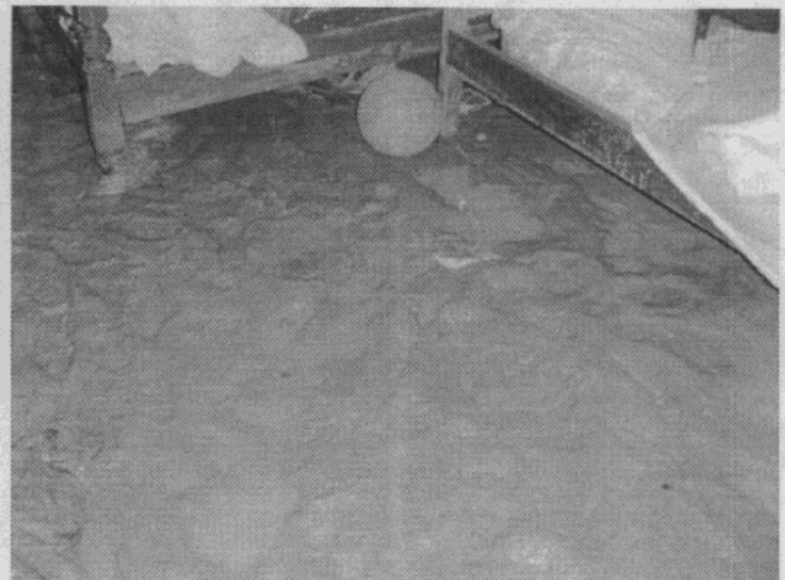
Foto 4: Lodos dentro de las habitaciones de la vivienda
