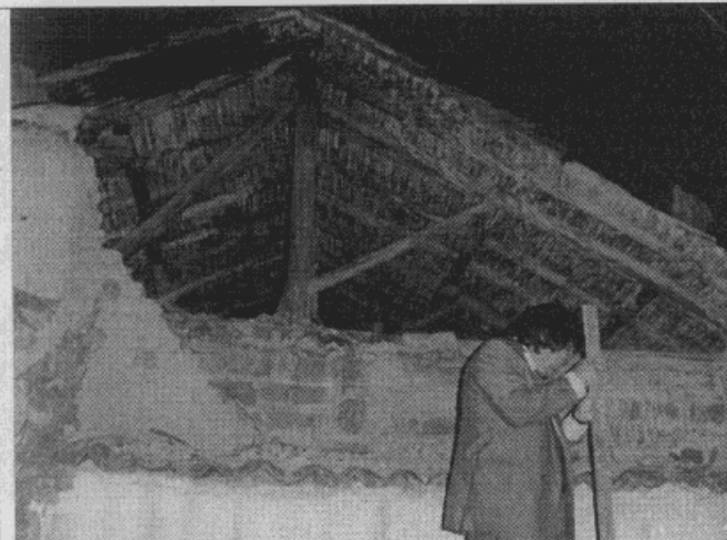
Foto 1: Caída del muro de culata, en adobes de barro, del inmueble de la Calle 5 # 3 - 24.
