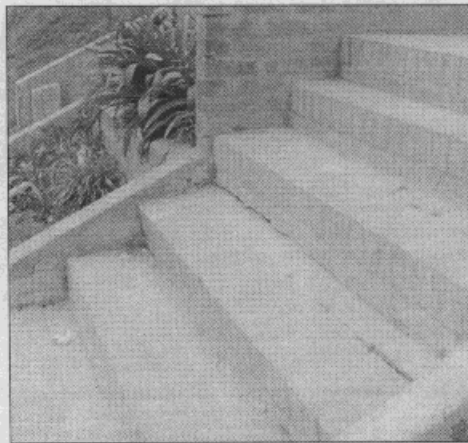
Fotografía 7 Inclinación de los peldaños
