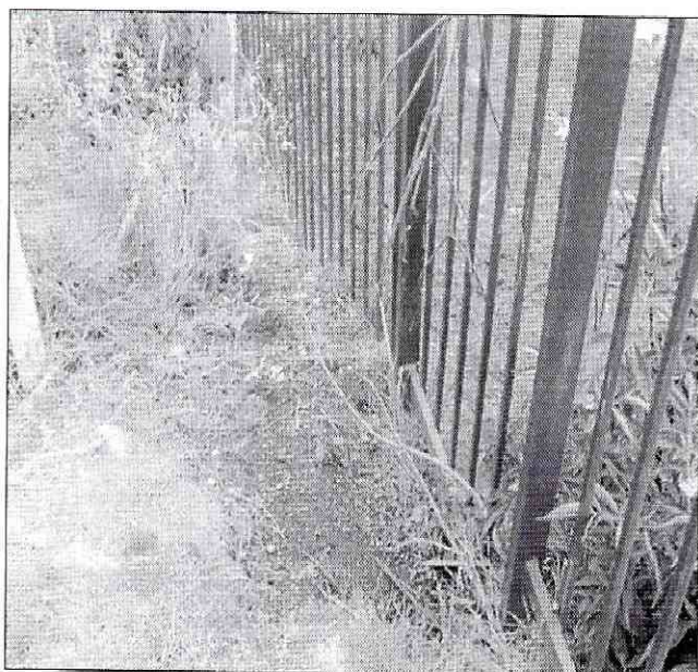
Fotografía 17. Hundimiento en la esquina nororiental de la cancha de la escuela.
