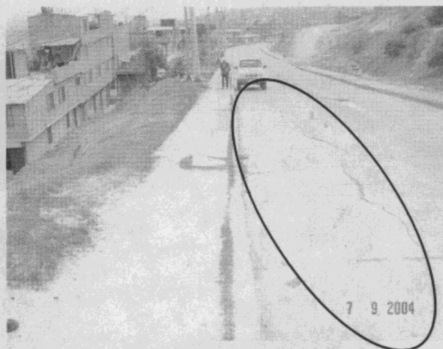
Fotografía 10. Hundimiento y agrietamiento del carril norte de la Diagonal 75 Sur frente al muro en gaviones.
