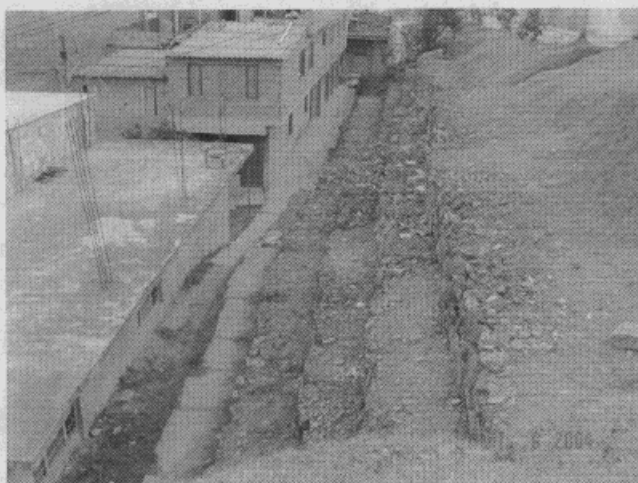
Fotografía 9. Se observa el arqueo del muro en gaviones.
