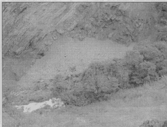
Fotografía 2. Se observa el material caído que está obstruyendo parcialmente el flujo del agua.
