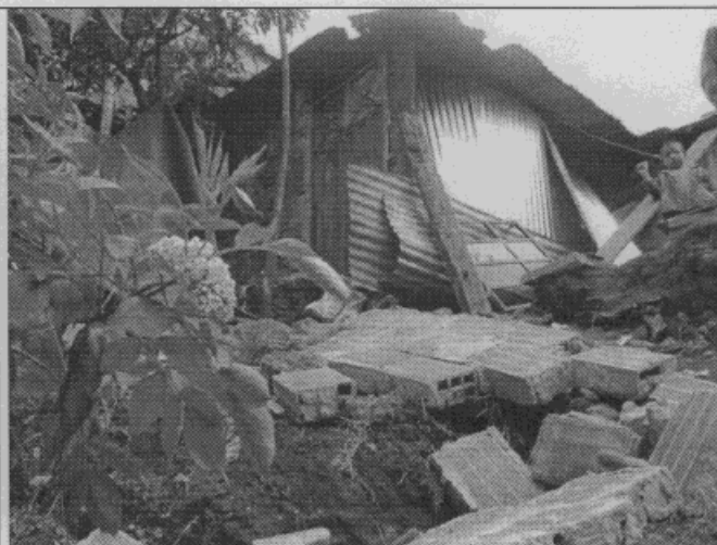
Foto 2. Vista general en la que se observa la casa prefabricada y la vivienda en material de recuperación; las tejas fueron suministradas por la DAPE con la finalidad de restringir el área afectada del resto de la vivienda.
