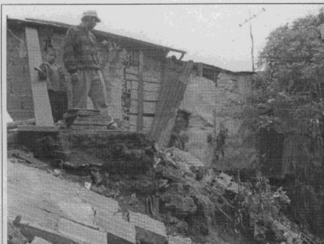
Foto 1. Vista general sector afectado; los muros no contaban con una cimentación y estos se apoyaron directamente sobre materiales de relleno en estado suelto.
