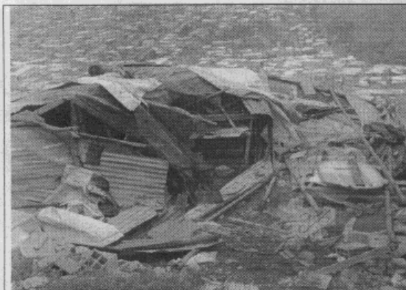
FOTO 1. Obsérvese los bloques caídos sobre la vivienda en material de recuperación.
