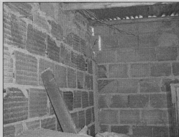
Fotografía 4. Se observa grieta en la junta entre dos muros perpendiculares entre sí en una de las alcobas.
