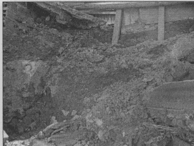
Fotografía 2. Detalle del material de relleno que se deslizó. Obsérvese la mala calidad de éste.
