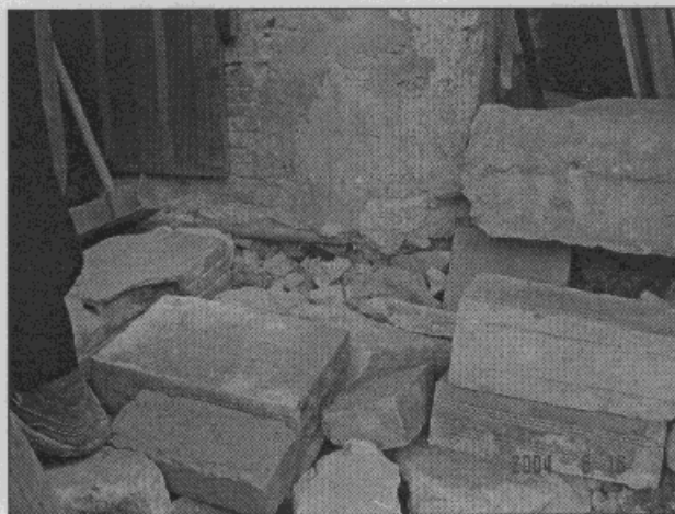
Fotografía 7. Se observa la deficiente cimentación de una de las columnas de la vivienda.
