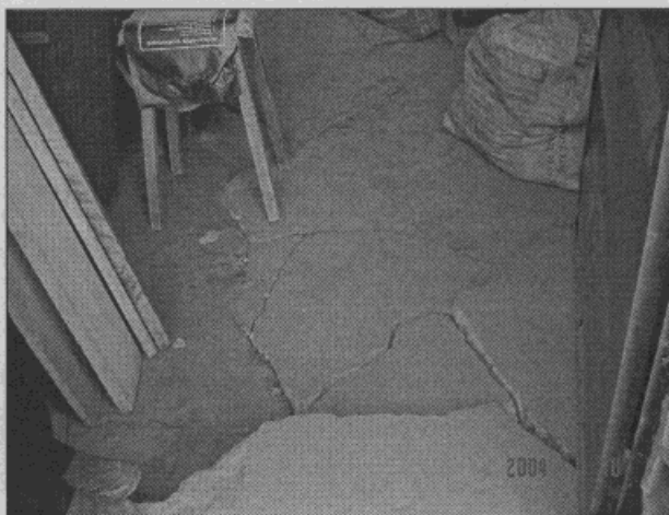
Fotografía 6. Hundimiento y agrietamiento del piso de la vivienda.
