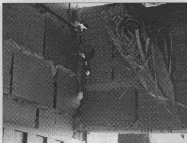
Fotografía 5. Grieta en la junta de intersección de dos muros perpendiculares entre sí, a la entrada de la cocina.
