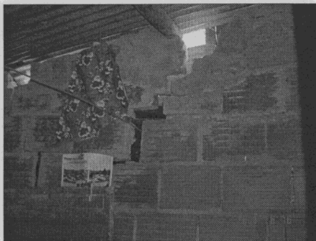
Fotografía 3. Grieta y pérdida de verticalidad del muro del costado norte de la vivienda.
