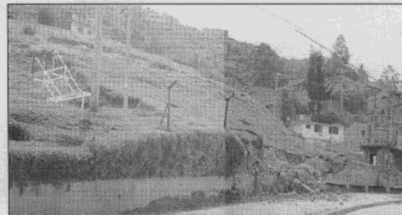
Fotografía 1 Daños en el cerramiento del costado occidental
