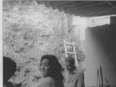
Fotografía 2 Destrucción del muro de mampostería
