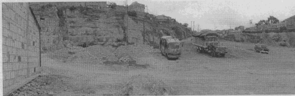
Fotografía 1. Vista del sector donde se presentó el desprendimiento de material
