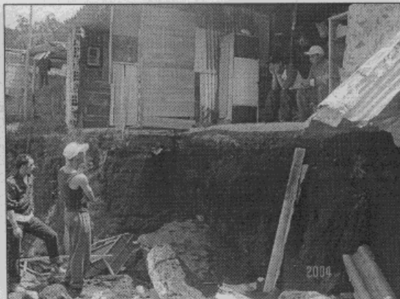
Foto 6. Se observa el costado norte del corte que protegía el muro colapsado; en donde también cayó la pared de la vivienda del interior 1 de la Carrera 7A No. 163 - 79.
