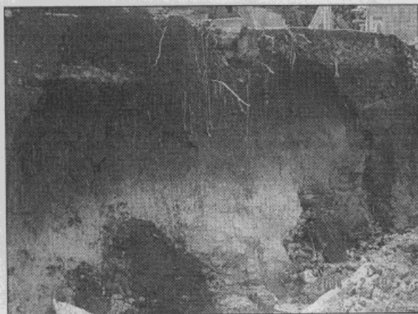
Foto 5. Vista del corte que protegía y contenía el muro colapsado, costado sur.
