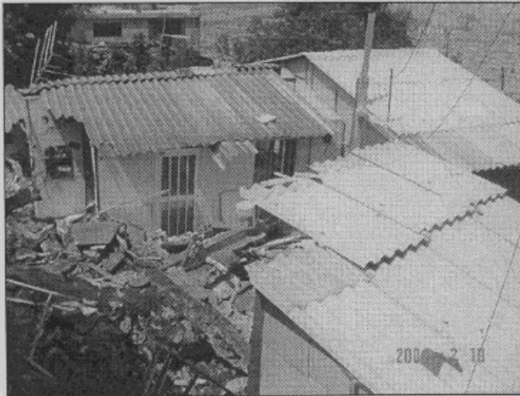
Foto 9. Vista de las 2 viviendas colapsadas del interior 1 de la Carrera 7A No. 163 - 79.
