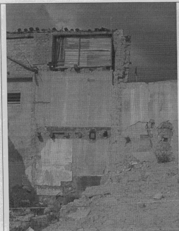
Foto 5. Detalle foto 4. Se observa perdida de verticalidad en la parte superior del muro.
