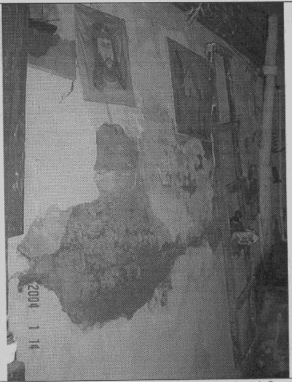
Foto 6. Vista interior muro sótano costado oriental. Se observan agrietamientos y desprendimiento del acabado del muro, adicionalmente se evidencia humedad en muro y placa de contrapiso.
