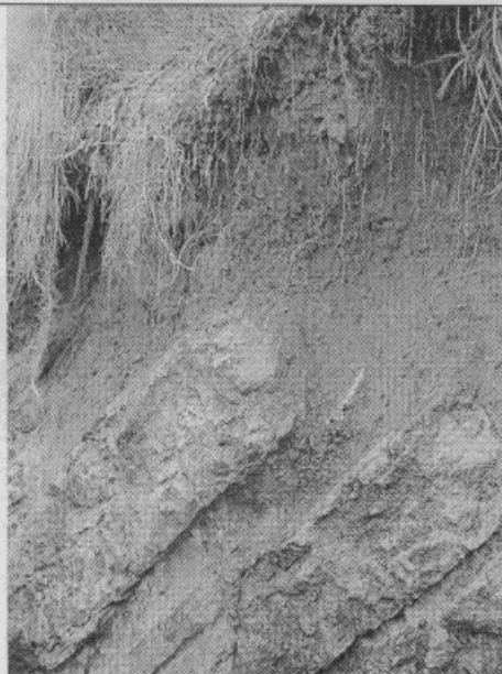
Foto 1. Conformación del talud de corte entre las viviendas ubicadas en la Calle 81 B Bis Sur No. 19-39 y No. 19-45.
