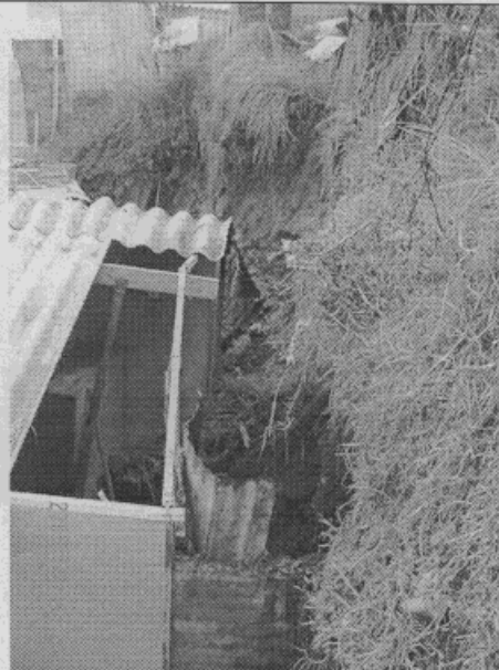
Foto 2. Vivienda ubicada en la Calle 81 B Bis Sur No. 19-39. El material deslizado empujó la pared occidental del predio, ocasionando el deterioro parcial de la estructura.
