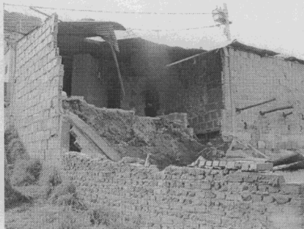
Foto 4. Vivienda ubicada en la Carrera 18Q No. 81C-26 Sur. Colapso parcial de la estructura debido a la falla por pandeo de la columna.
