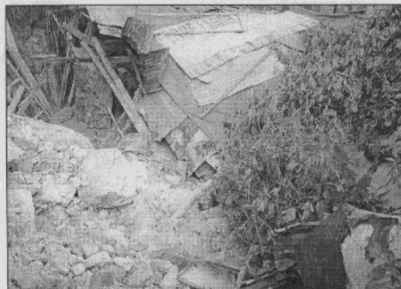
Fotografía 5 Caída de bloques a la vivienda ubicada en la Carrera 2C # 40A - 33 Sur
