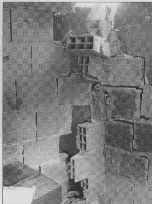
Fotografía 10. Agrietamiento y pérdida de elementos de mampostería a causa de la falla en el muro de contención de la vivienda del señor Rodríguez.
