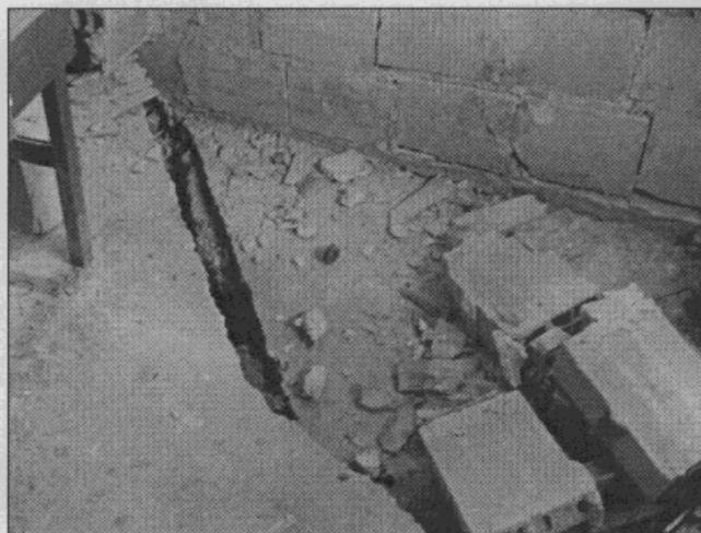
Fotografía 9. Hundimiento del piso del costado sur de la vivienda del señor Rodríguez en el sitio donde el muro de contención ha fallado (fotografía anterior).
