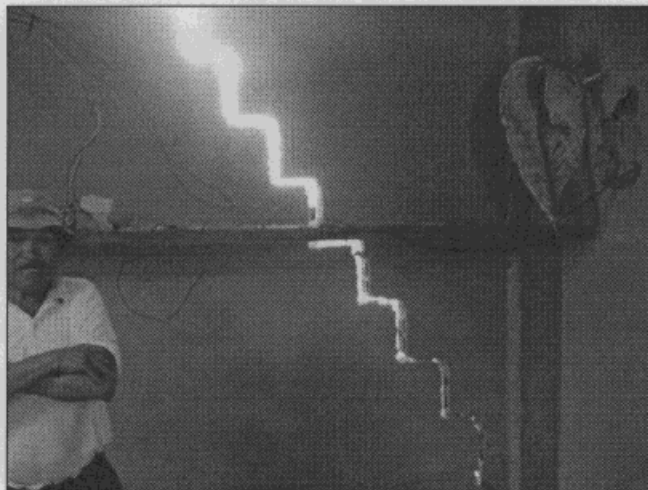
Fotografía 11. Agrietamiento de la pared sur de la vivienda del señor Rodríguez.
