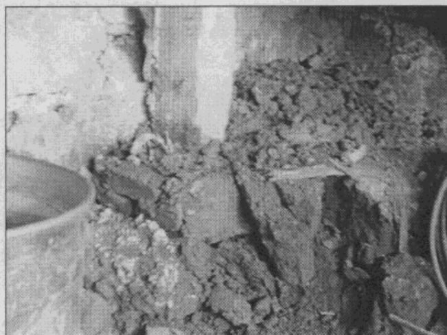
Fotografía 5. Obsérvese que la cimentación de las columnas de la vivienda de la señora Botía es deficiente tanto en dimensiones como en profundidad de apoyo. Así mismo se observa que el suelo de apoyo del muro de contención de la vivienda del señor Rodríguez se desconfinó y se ha ido perdiendo.
