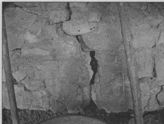
Fotografía 8. Agrietamiento del muro de contención para el relleno de nivelación del predio del señor Rodríguez. Se considera que éste se debió a la pérdida de confinamiento y de cimentación.
