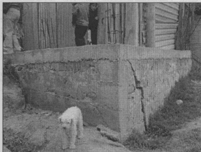
Fotografía 14. Grieta en el muro de contención para nivelación del terreno en el predio de la Señora Mantilla.
