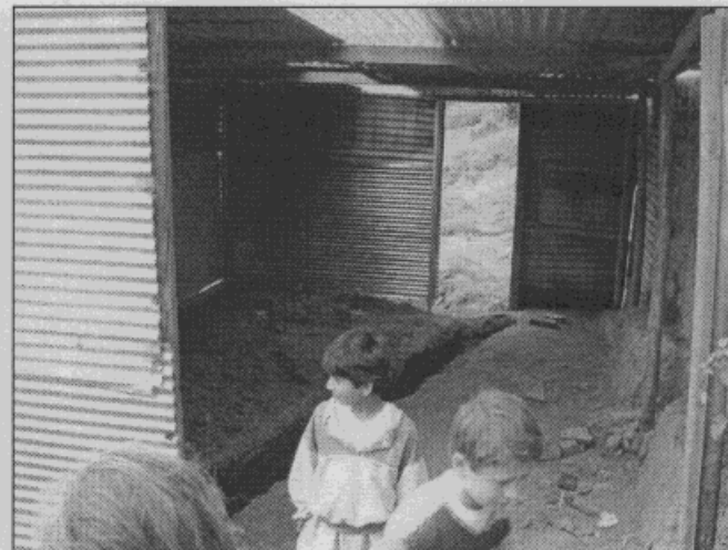
Fotografía 12. Se observa el lote vecino del extremo norte del predio del señor Rodríguez, que se encuentra actualmente en construcción y que se recomienda suspender tal proceso y no ocupar.
