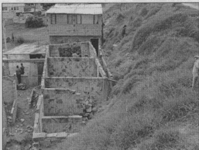
Fotografía 3. Viviendas en construcción en la parte inferior de la vía, que se ven afectadas por el deslizamiento ocurrido allí.
