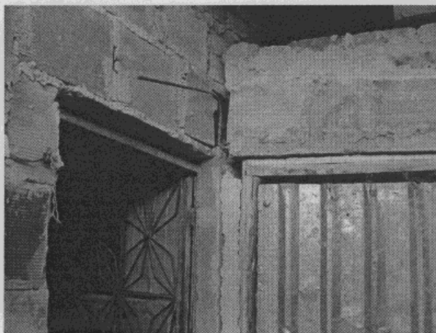
Fotografía 13. Grieta en la junta de intersección del muro de cocina con el del patio de la vivienda del señor Romero.
