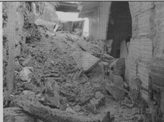
Fotografía 2. Deslizamiento contra la vivienda.
