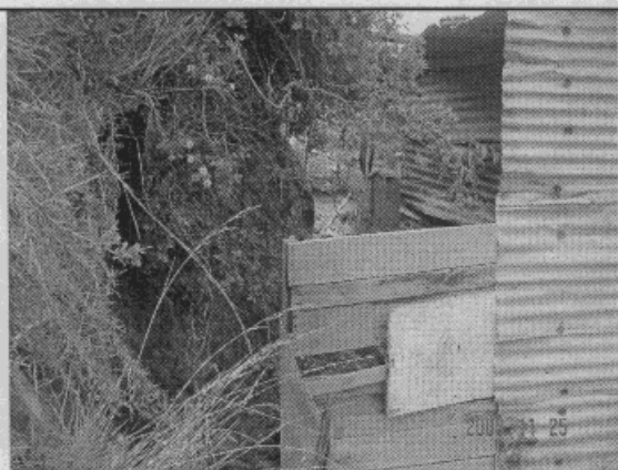
Fotografía 3. Escarpe dejado por el deslizamiento.
