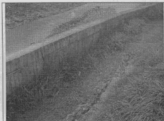
Foto 3. Grietas generadas por el hundimiento del suelo
