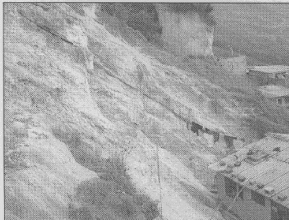
Fotografía 3 Caída de bloques en proximidad de la vivienda prefabricada
