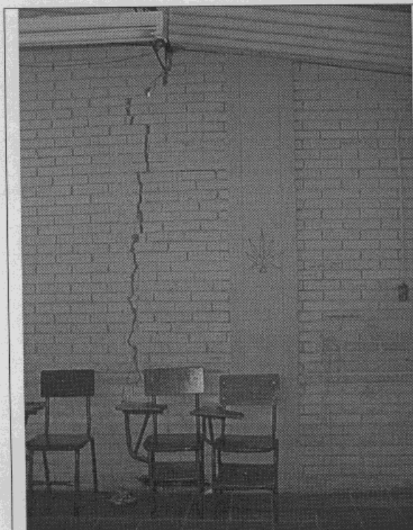
Foto 7. Agrietamiento vertical en muro localizado en el aula y laboratorio (sector occidental). El agrietamiento coincide con el punto de apoyo de la correa metálica de cubierta. La columna contigua fue fundida hace aproximadamente un año.
