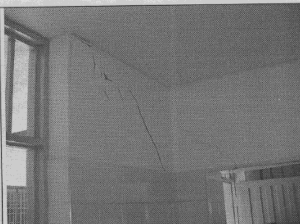
Foto 10. Agrietamiento diagonal en muro del primer piso en la zona de baños. Corresponde al mismo agrietamiento registrado en la foto 6.
