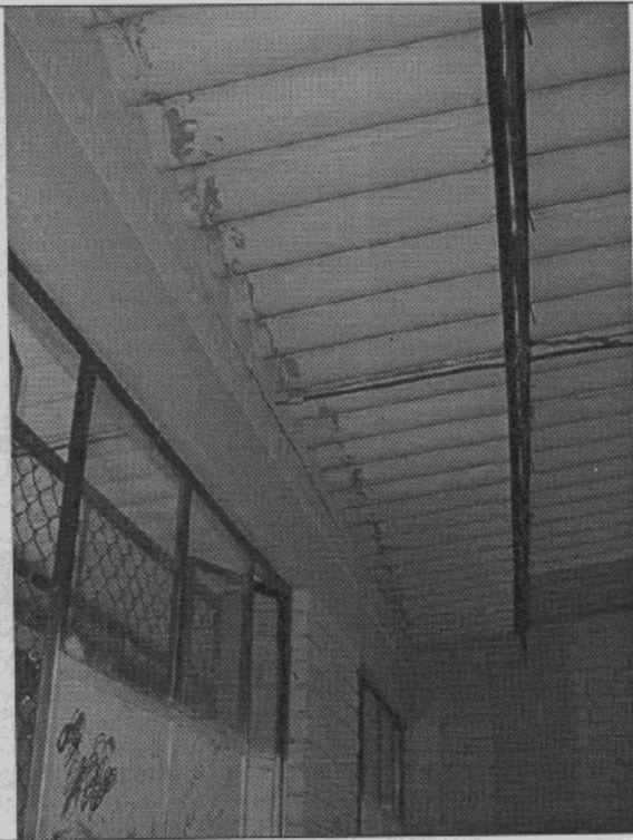
Foto 8. La marca dejada en las tejas indica el desplazamiento que ha presentado el muro de fachada localizado en el aula y laboratorio (sector occidental). El apoyo de la teja sobre la correa es insuficiente.
