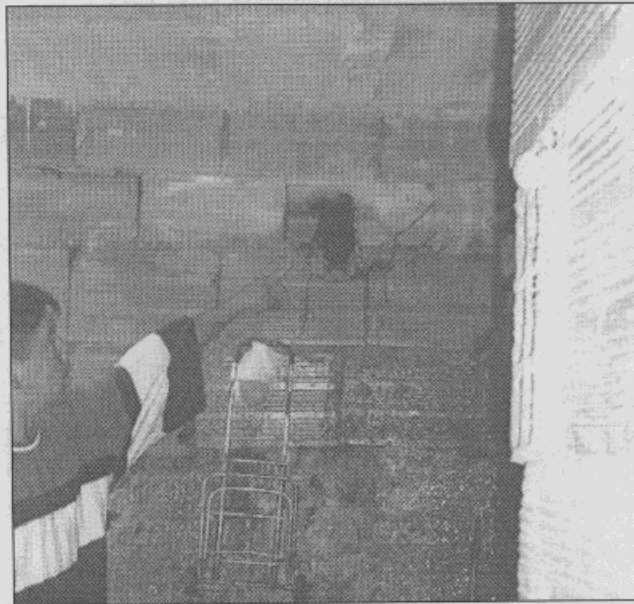
Fotografía 1 Orificio realizado para evacuar y aliviar presiones de agua
