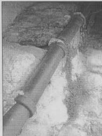
Fotografía 2 Tubería de alcantarillado sin recubrimiento
