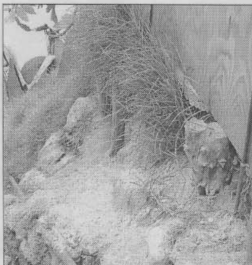
Fotografía 4 Ausencia de confinamiento costado sur
