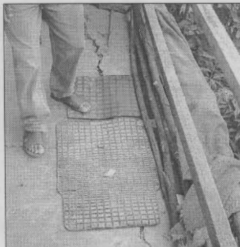
Fotografía 6 Agrietamiento placa de contrapiso
