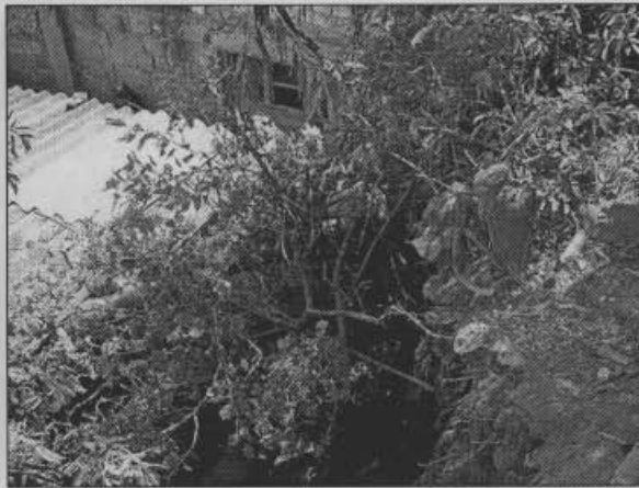
Foto No.6. Vista del escarpe; a la izquierda el techo de la vivienda prefabricada afectada.
