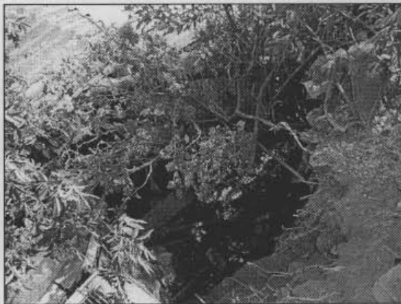
Foto No.5. Vista del escarpe; a la izquierda el techo de la vivienda prefabricada afectada.
