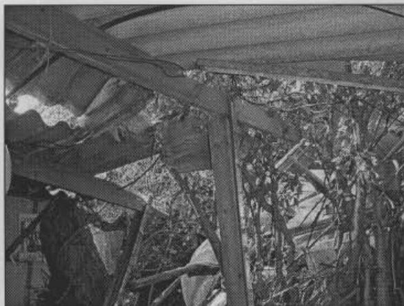
Foto No.9. Se observan los daños causados en el extremo oriental de la cubierta de la vivienda prefabricada del interior 3.
