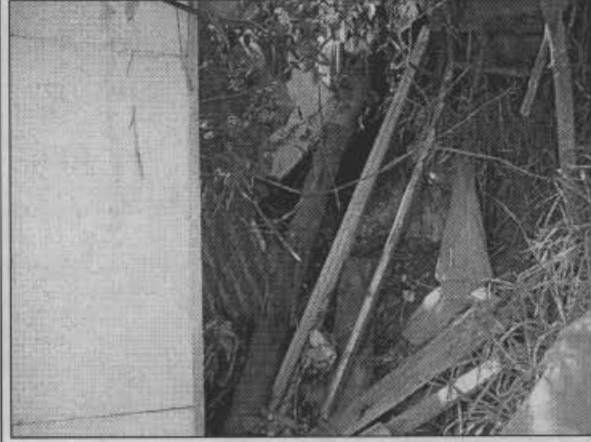
Foto No.2. Se observan tablas, palos, basura, etc. Que se cayó de la parte superior del corte a raíz del deslizamiento (esquina surorientada de la vivienda).
