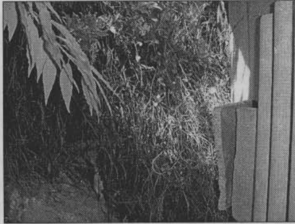
Foto No.1. Vista del material deslizado contra el muro del costado orientado de la vivienda prefabricada del interior 3.
