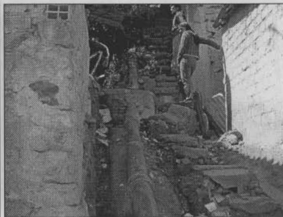
Foto No.12. Vista del peatonal que da acceso a la vivienda; obsérvese la tubería de aguas servidas y una acequia por la que discurre parte de la escorrentía del sector.
