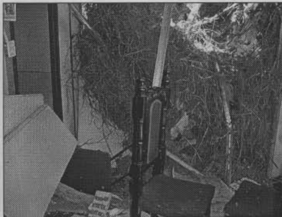
Foto No.10. Se observa el material depositado en la sala de la vivienda.
