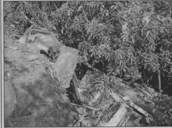
Foto No.4. Vista del escarpe, donde se observan algunos de los elementos caídos a raíz del deslizamiento.
