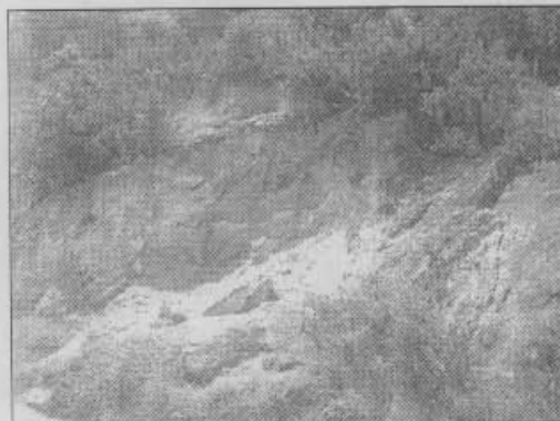
Fotografía 2 Detalle de la zona de caída de roca
