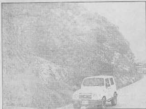
Fotografía 1 Vista general del talud inestable
