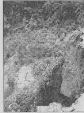
Fotografía 4 Descarga de aguas negras al talud
