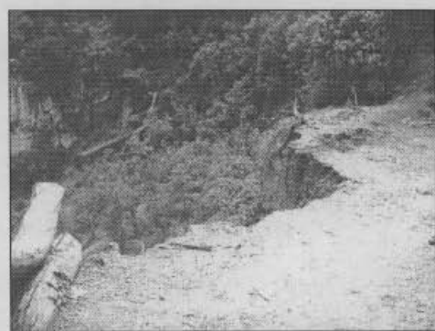
Fotografía 2 Perdida gradual de terreno por desprendimiento
