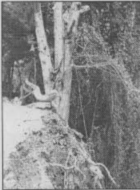
Fotografía 3 Acción de inestabilización por árboles
