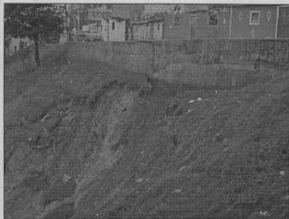
Foto No.1. Vista del escarpe del deslizamiento ocurrido el 30 de mayo de 2002; foto tomada en ese momento.
