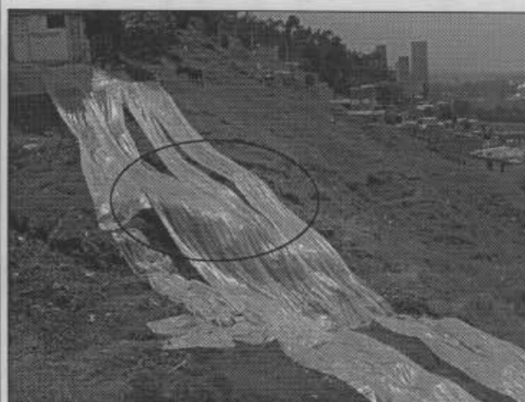
Foto No.6. Vista del sector afectado por grietas de tracción, ver detalle en la foto No. 7.
