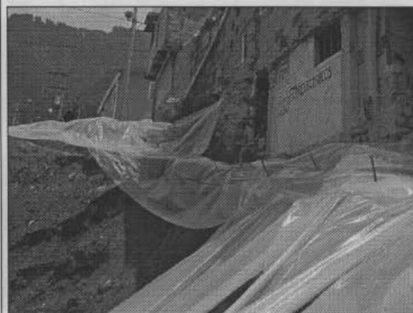
Foto No.8. Se observa la cercanía del escarpe a la vivienda.
