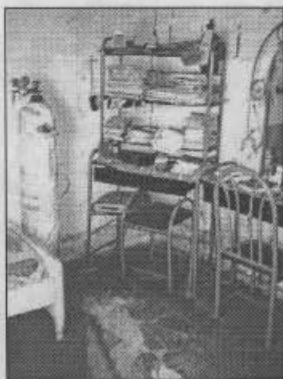
Fotografía 8 Agrietamiento de piso y muros (Ítem 5)
