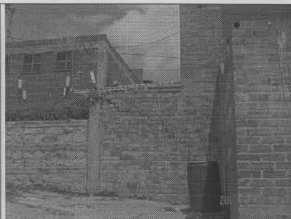
Foto 10. Bloque B2. Se observa agrietamiento diagonal en muro de fachada del primer piso.
