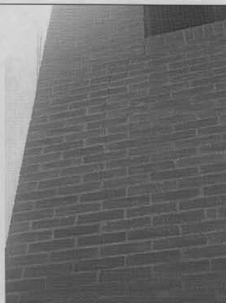
Foto 15. Continúa agrietamiento vertical como se observa en la foto 14 en el segundo piso.
