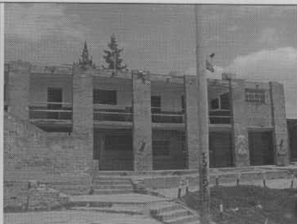
Foto 9. Bloque B2. En el momento de la visita se estaba realizando su evacuación.
