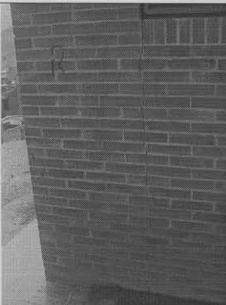
Foto 14. Agrietamiento vertical muro de fachada primer piso del Bloque B3.
