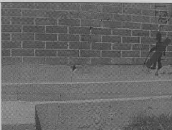
Foto 7. Detalle agrietamiento viga de cimentación y muro de fachada del Bloque B6 localizado en el costado que se observa en la foto 6.
