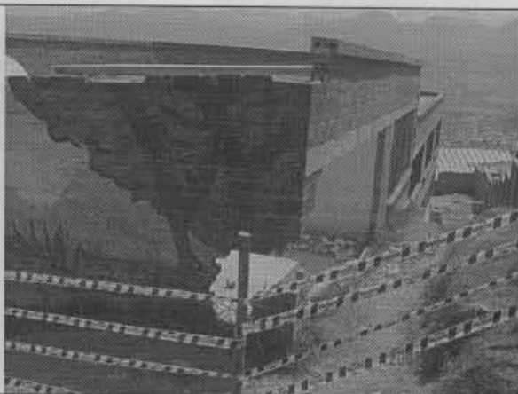
Foto 5. Bloque B5: se observa desprendimiento de las piezas de mampostería y caída de la cubierta.
