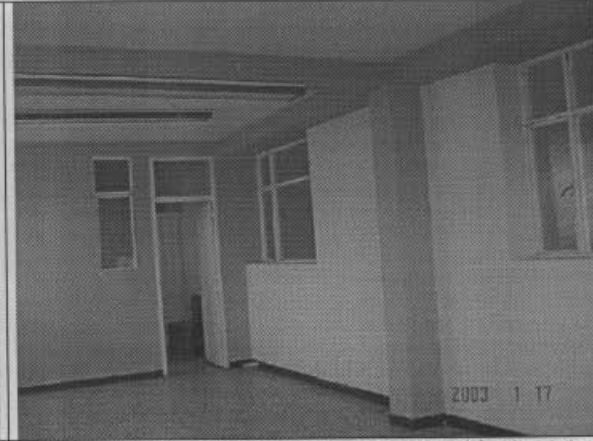
Foto 24. Vista interior Salón Comunal Laguneta. Se observa sistema de pórticos de concreto, que corresponde a una ampliación adosada.
