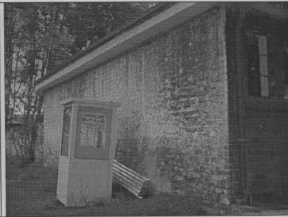
Foto 2. Vista posterior Salón Comunal Acevedo Tejada; su sistema estructural es de mampostería no reforzada.
