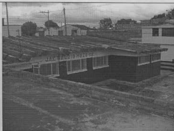
Foto 8. Vista general Salón Comunal Barrio Muzu. Algunas tejas no cuenta con el amarre adecuado y se pudo establecer que las tejas se corrieron de su posición original
