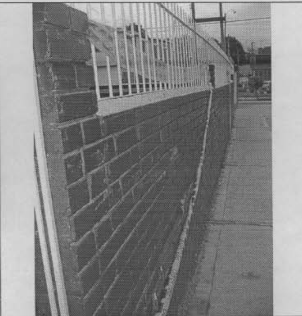
Foto 12. Muro de cerramiento; ha perdido verticalidad y está suelto.
