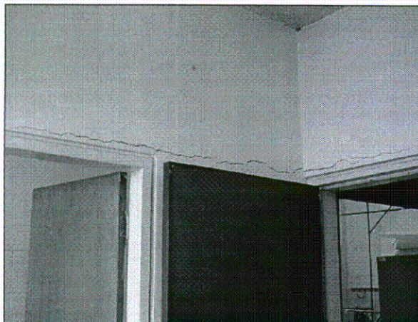
Foto No. 7. Gritas sobre los marcos de las puertas de las oficinas del costado oriental de edificio de salones.
