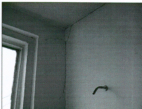
Foto No. 6. Grietas en la junta de los muros del costado oriental del cuarto piso del edificio de salones de clase.
