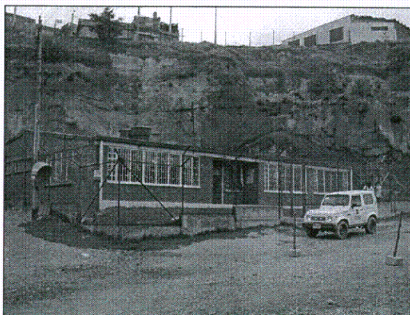
Foto No.1. Vista del jardín infantil y del talud rocoso recubierto con concreto lanzado, malla y pernos de anclaje.
