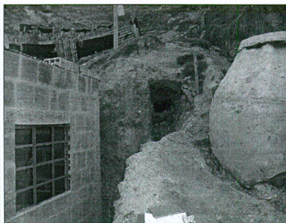
Foto No.6. Vista del orificio que ha dejado el lavado del suelo a raíz del flujo de agua ladera abajo y se discurre por la tubería de agua potable.
