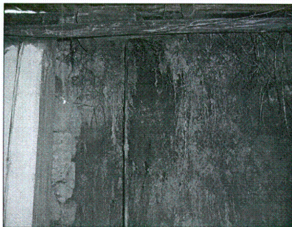
Foto No.3. Vista del talud. Se observa bastante meteorizado. El tubo que se observa corresponde a la acometida de acueducto; la columna esta hecha en concreto y según los propietario es el límite del lote.
