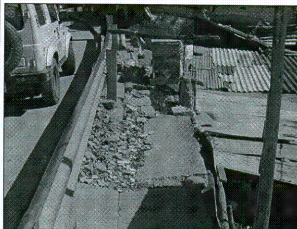
Foto No.2. Se observa hundimiento del andén paralelo a la carretera oriente. Obsérvese la proximidad de la vivienda al talud y a la vía.
