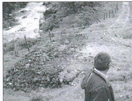
Fotografía 3 Acumulación de materiales en el borde del talud
