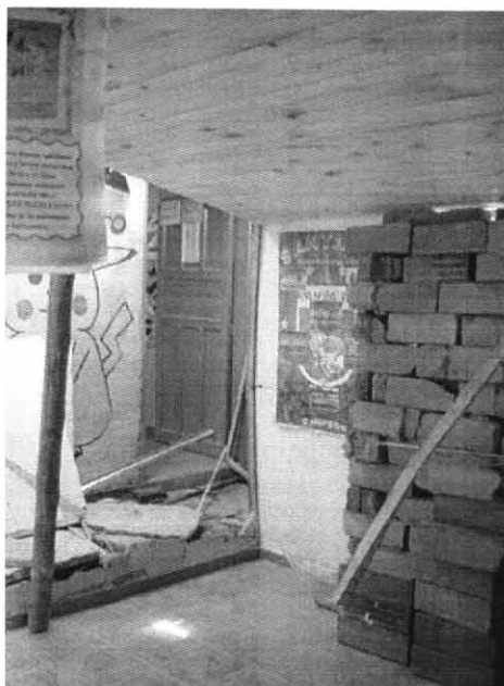
VISTA EXTERIOR E INTERIOR DE VIVIENDA PREFABRICADA EN LA QUE SE ROMPIERON ALGUNOS PANELES DE CONCRETO Y SE CAYÓ PARTE DEL MURO DE CERRAMIENTO POSTERIOR
