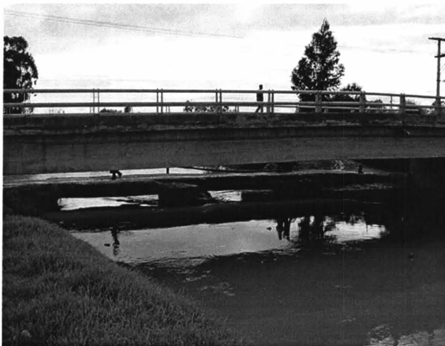
Foto 5. Vista hacia aguas arriba del río Tunjuelito en el cruce del río Tunjuelito con la carrera 86 zona del barrio Antonia Santos en la localidad de Bosa.
